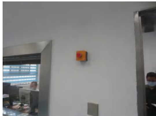
图 3-16 机房内紧急停机按钮
