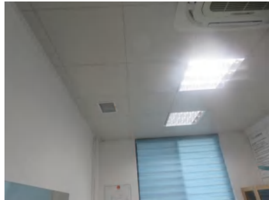
图 3-28 控制室内进风口
