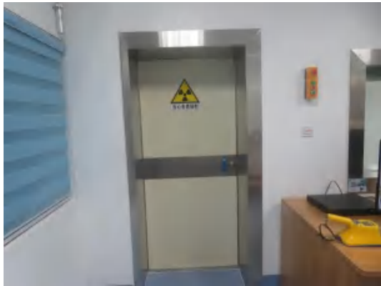
图 3-27 控制室出入防护门
