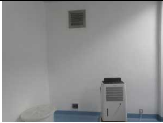
图 3-31 PET/CT 机房内排风口
