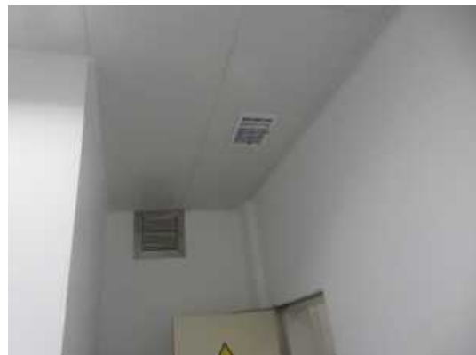
图 3-30 观察室内进排风口
