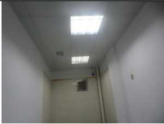
图 3-23 注射后候检室内进风及排风口
