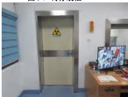
图 3-11 控制室出入机房防护门
