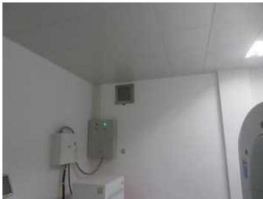
图 3-15 机房内排风口
