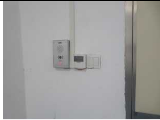
图 3-24 候检室语音呼叫系统
