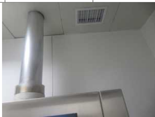
图 3-20 氟分装柜排风管
