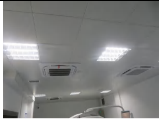
图 3-14 机房内空调进风口
